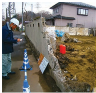
■ 地震で倒壊寸前のブロック塀をチェック
